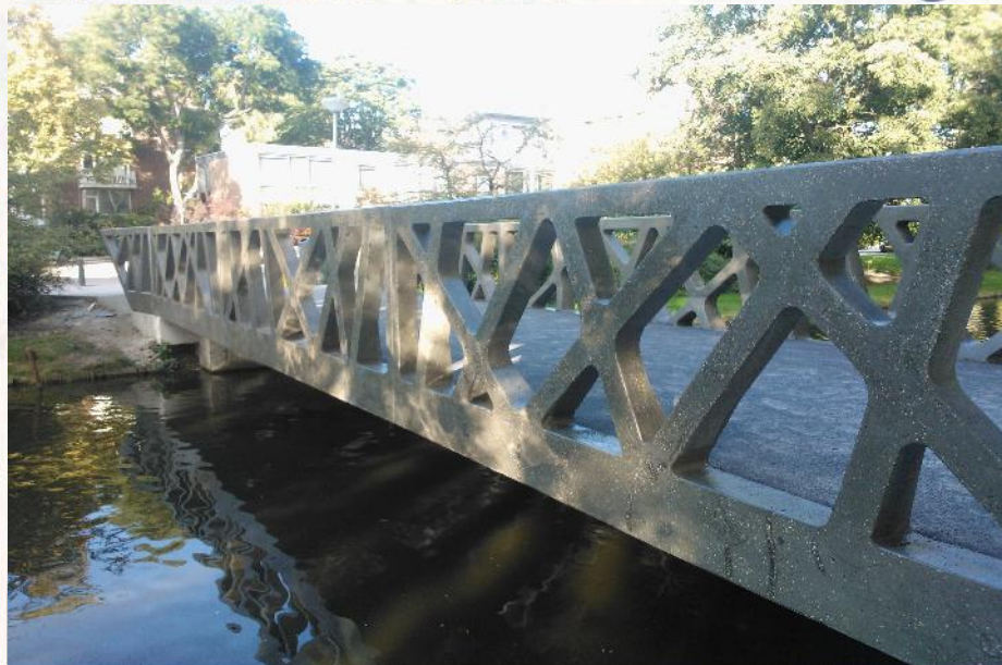
De Hoekersingelbrug van ultrahogesterktebeton in het stadsdeel Delfshaven van de gemeente Rotterdam.
